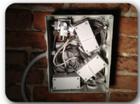
Scatola sensori ed elettroniche per monitoraggio cablato.
